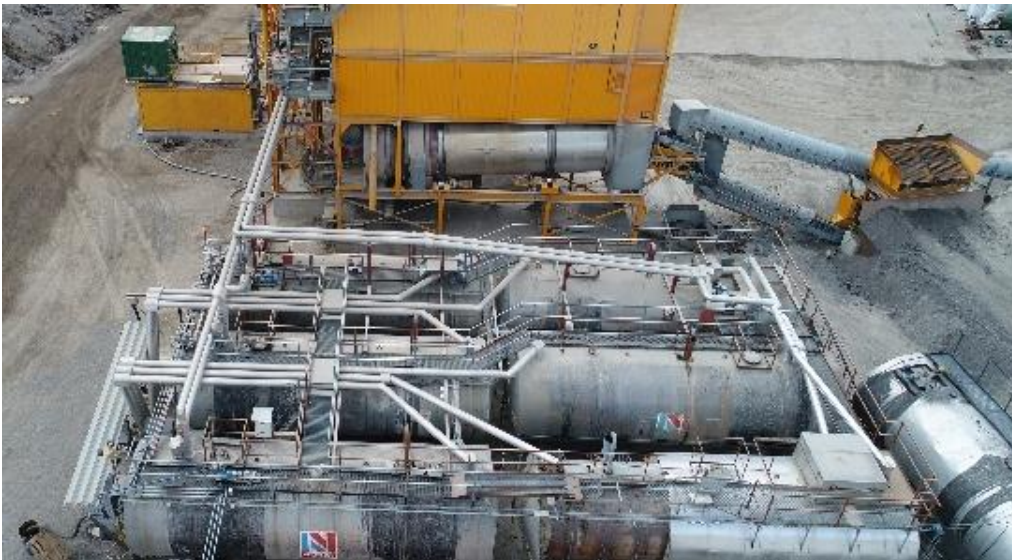
Kiinteän asfalttiaseman sideaineen varastosäiliöt. Kiinteä putkisto mahdollistaa eri sideaineiden sekoittamisen
