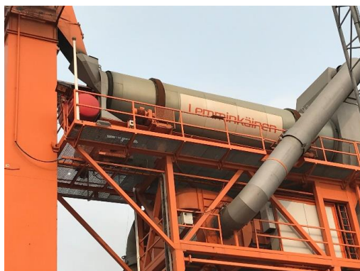
Asfalttiasema, jossa on asfalttirouheen kuumennukseen soveltuva erillinen kuumennusrumpu.
